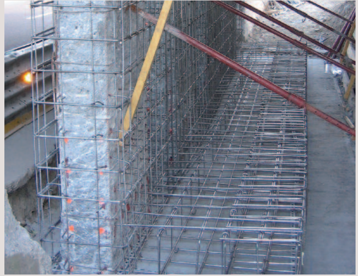
→ Réparations des piles de ponts endommagées par la corrosion (sel de déverglaçage).
