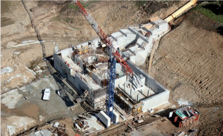
→ Centrale hydroélectrique du barrage de Rizzaneze (Corse).
